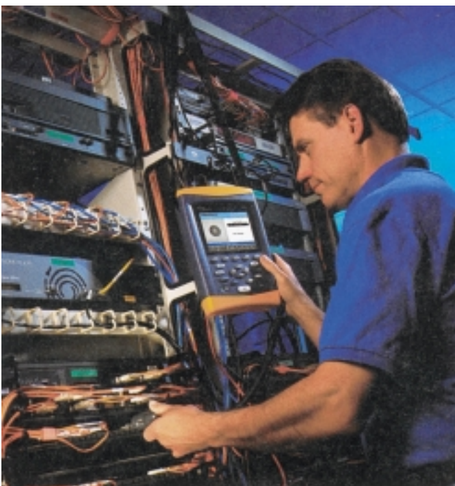
Μια ηλεκτρική εγκατάσταση που έχει ελεγχθεί, προσφέρει μεγαλύτερη ασφάλεια και σιγουριά στον τελικό καταναλωτή.
