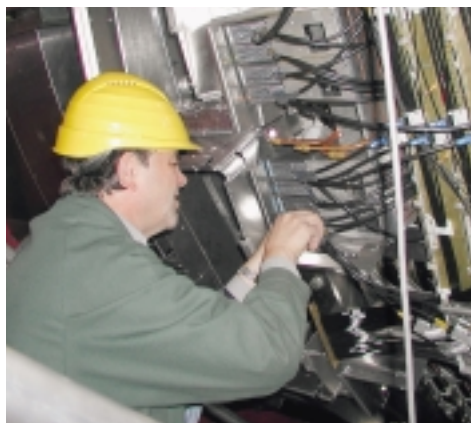
Αν προσπαθήσει ο χειριστής να κάνει τη μέτρηση με την εγκατάσταση υπό τάση, το όργανο δείχνει την τάση που βρίσκεται στην εγκατάσταση και δεν προχωρεί στη μέτρηση.
